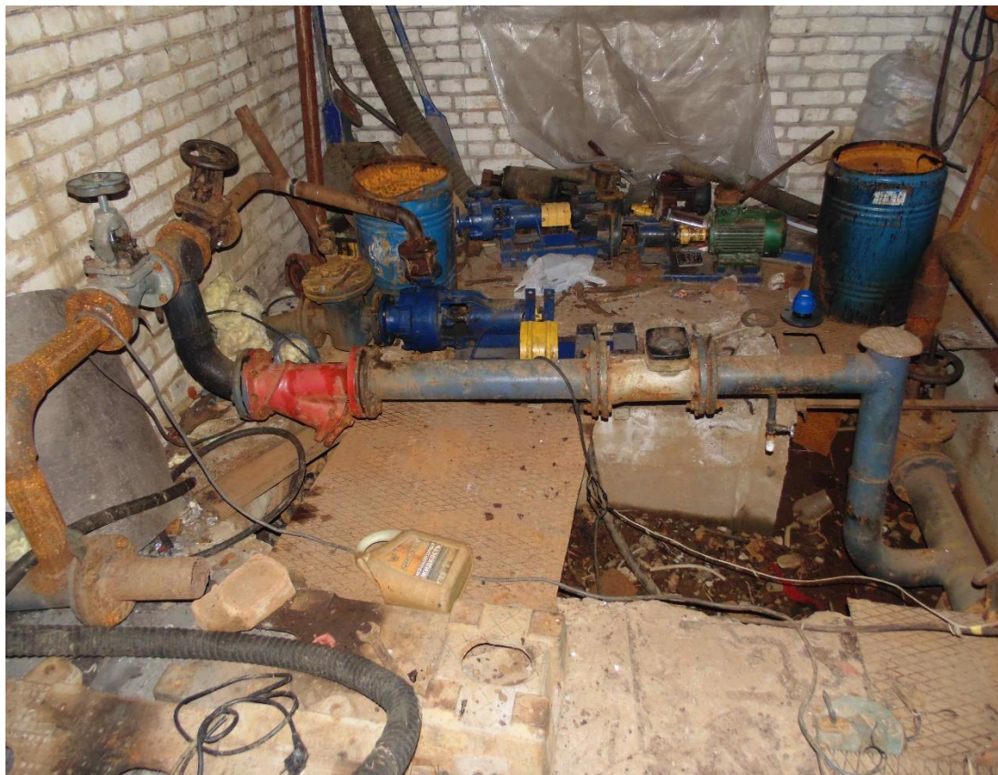
Рисунок 1.4.2 – Оборудование водозаборного сооружения
