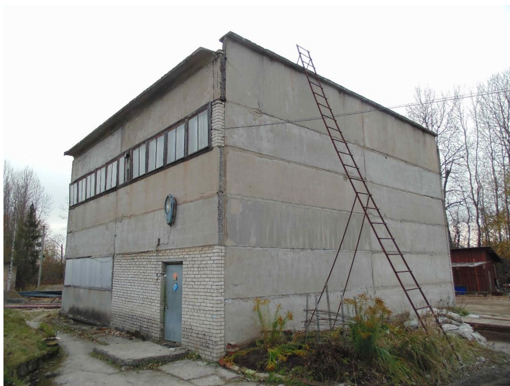
Рисунок 1.4.3 - Насосная станция второго подъема
