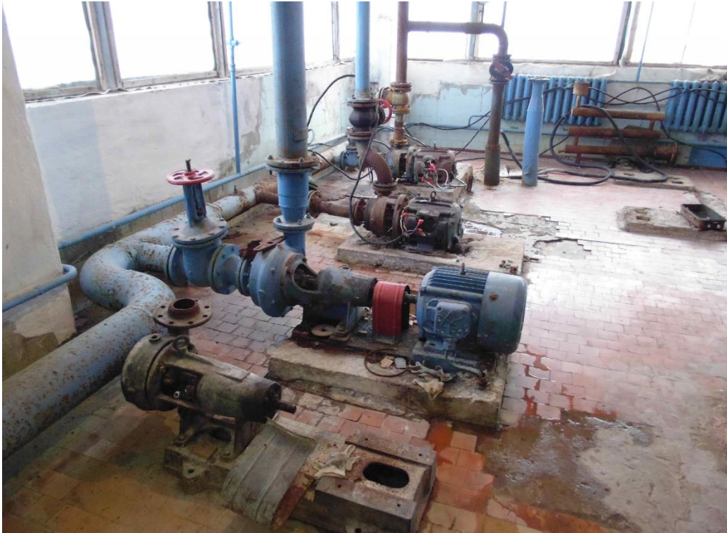
Рисунок 1.4.4 - Рабочее оборудование насосной станции 2 подъема.
