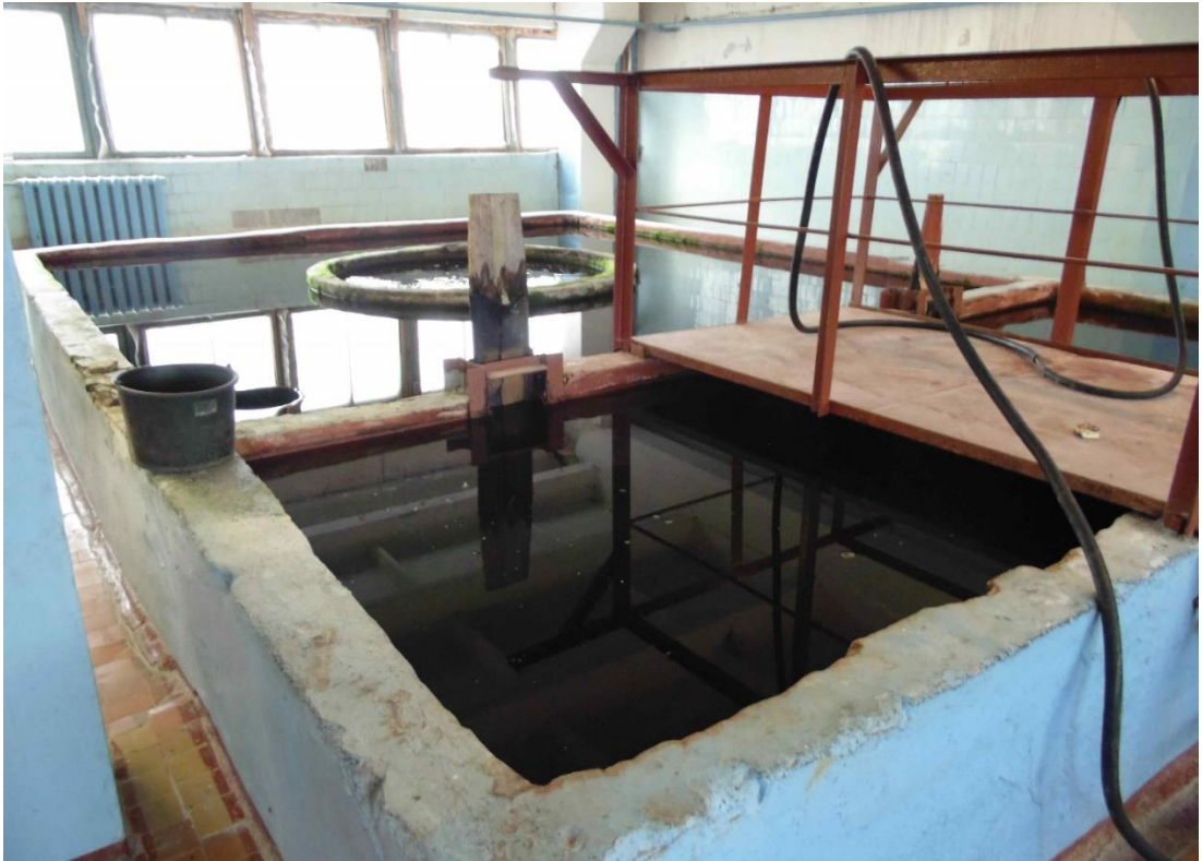
Рисунок 1.5.1 - Рабочее оборудование насосной станции 2-го подъема (отстойник).
